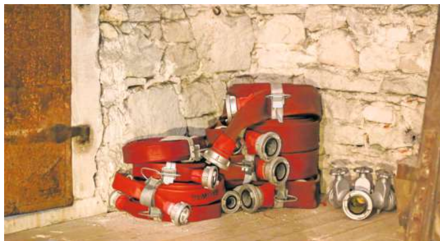
Bereitgelegte Feuerwehrschräume an der Klostermauer.
